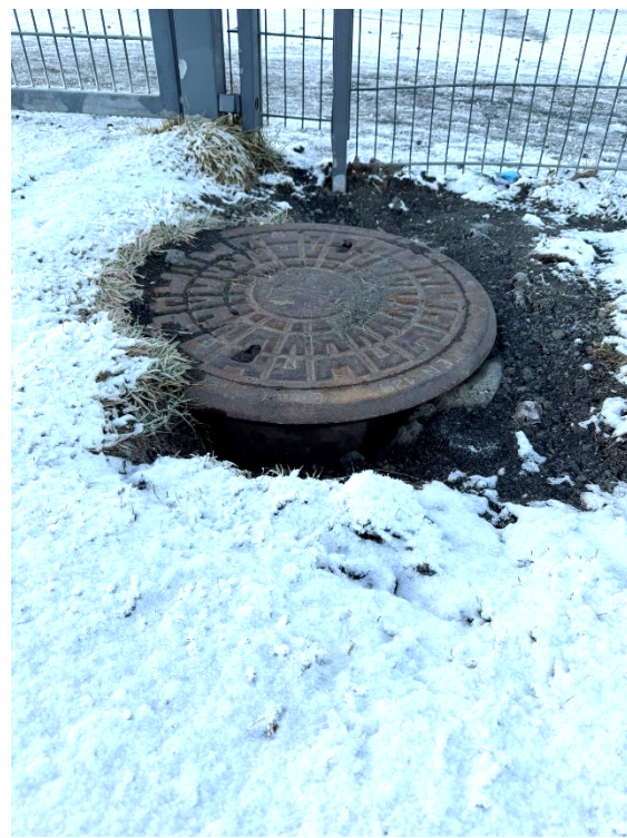
Mynd 4. Frágangi við brunnlok ófullnægjandi.
